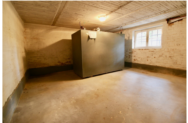
Keller mit Heizöltank
